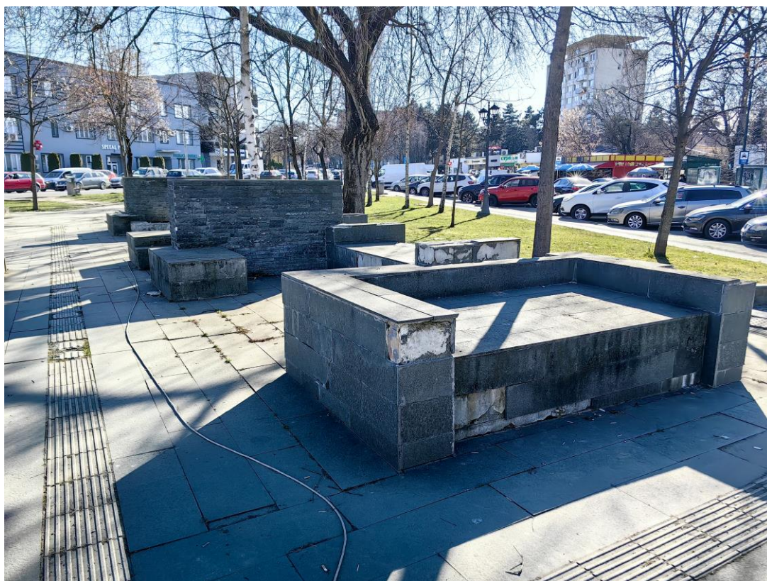
Foto nr. 3 Bancă de beton armat deteriorată
