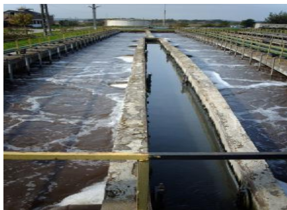
Figura Nr. 2-46 – Bazinul de aerare
