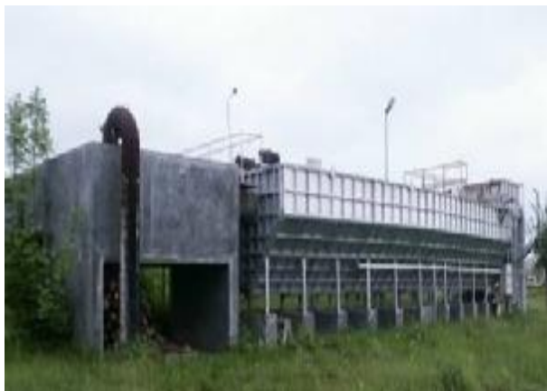
Figura Nr. 2-11 – Unitatea de îndepărtare nisip și grăsime
