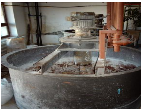
Figura Nr. 2-35 – Rezervorul de pregătire a sulfatului de aluminiu
