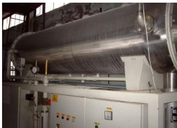
Figura Nr. 2-17 – Instalație de ozon
