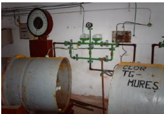
Figura Nr. 2-27 – Stația de clorare
