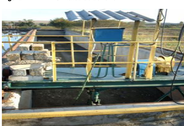
Figura Nr. 2-14 – Bazinul secundar de sedimentare
