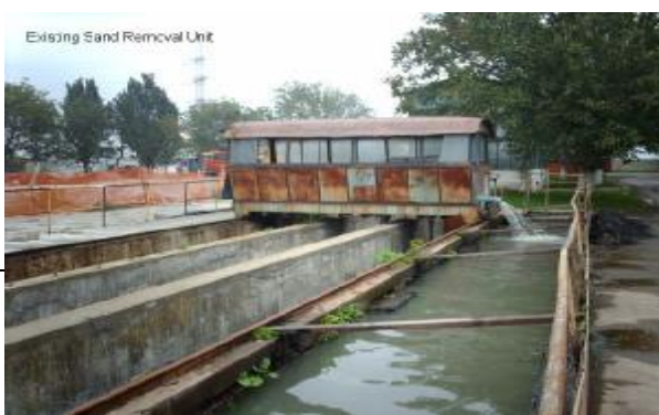
Figura Nr. 2-30 – Unitatea existentă de îndepărtare a nisipului
